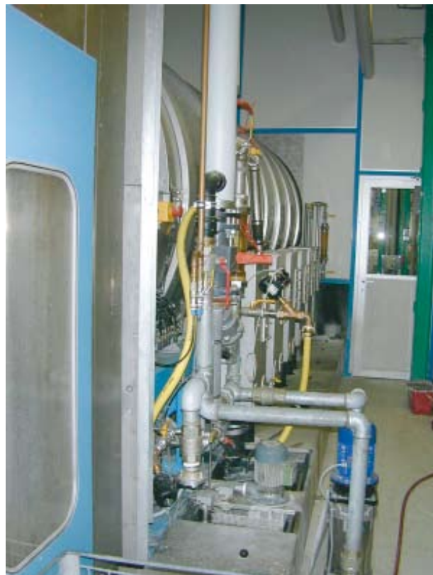
Figuur 16: Perswaterrecuperatie op een wasstraat (bron: JohnsonDiversey).
