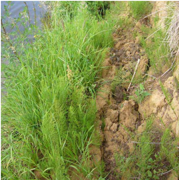
Figuur 5: Bermvegetatie die door erosie afgescheurd is van het hoger gelegen gedeelte en nu langs de waterlijn stand houdt.
