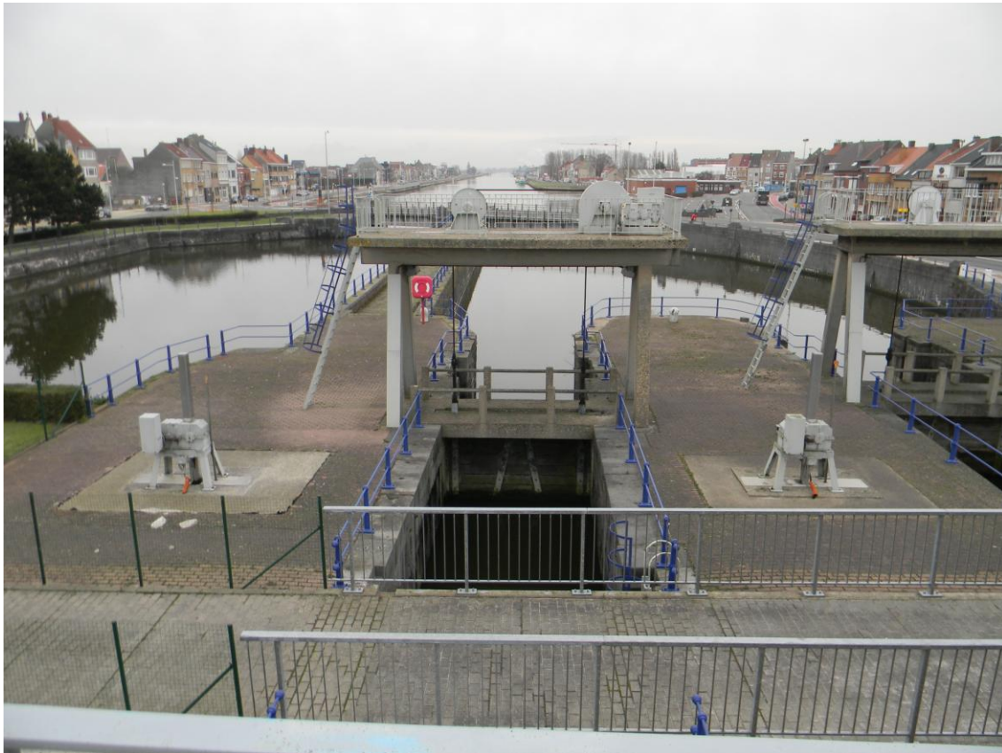
Fig. 7. Foto van één van de twee spuisluizen met schuifdeur van het Sas Slijkens in Oostende.
