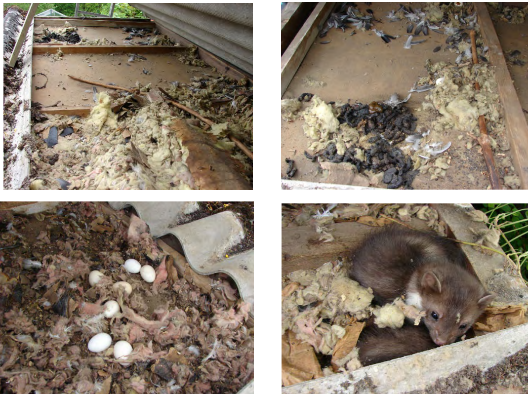
Figuur 25. Schade tussen dak en onderdak ten gevolge van een steenmarternestplaats (Westerlo 2010) – (foto's J. Van Kerckhoven).
