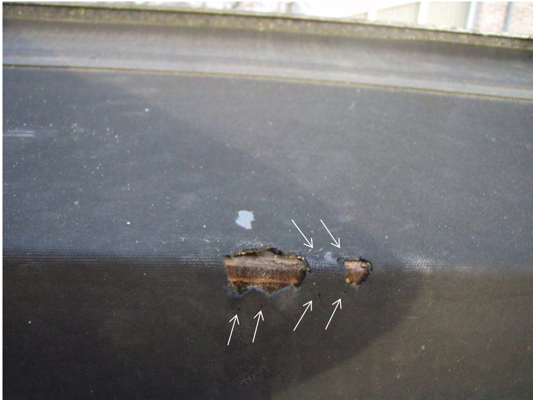
Figuur 27. Beschadiging van EPDM-folie op plat dak door bijtgedrag van een steenmarter ter hoogte van hoeken (foto boven; bemerk de kleine putjes als hoektandafdrukken cf. witte pijltjes) en sloven (foto onder), Tervuren 2010 (foto's E. Mahieu).
