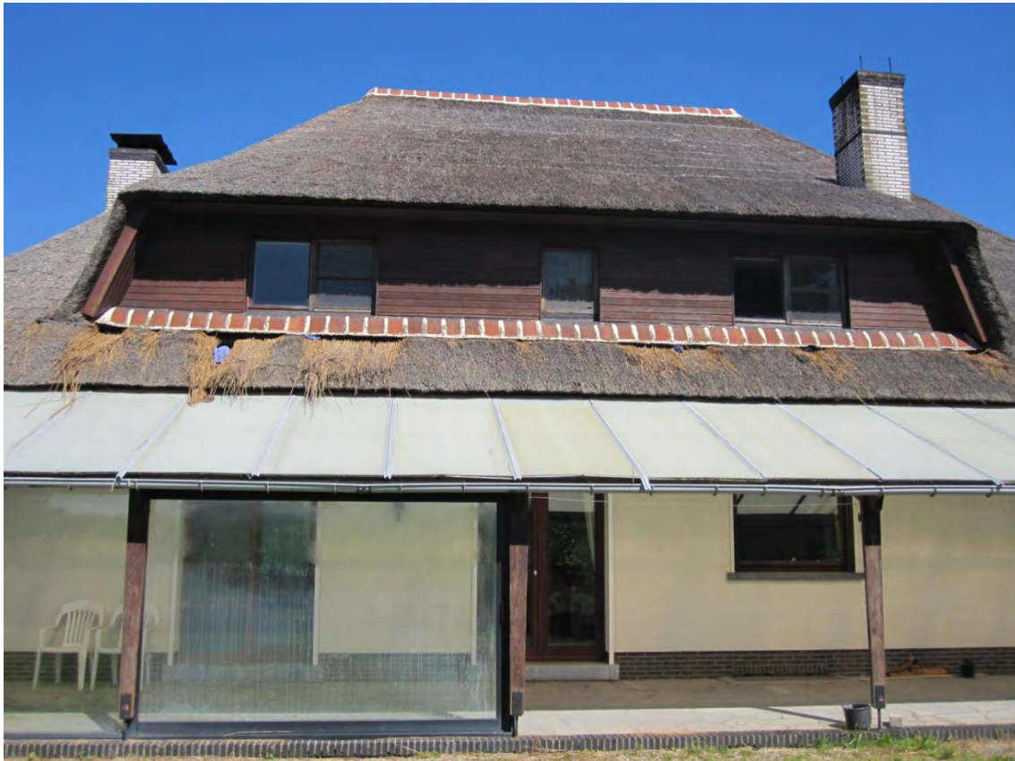
Figuur 26. Schade aan rietdak (met ingebrachte doeken ter afschrikkung om erger te voorkomen), Geraardsbergen 2012 (foto A. Bourdeaudhui).
