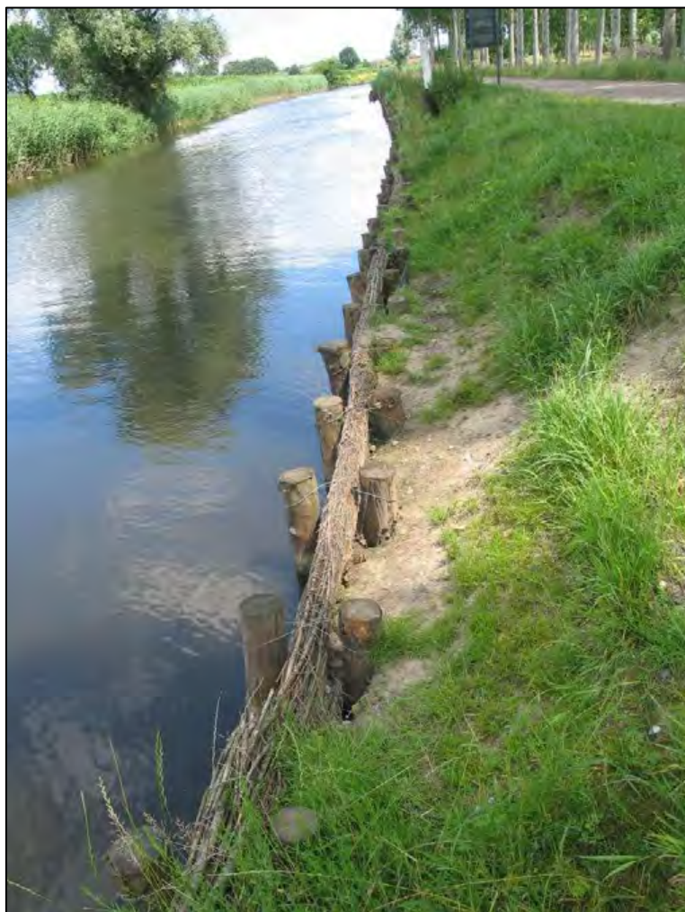
Foto 6. Constructie ter hoogte van de Coudenbormbrug (LO). Door de palen en wiepen tegen de oever te plaatsen, krijgt men een abrupte overgang tussen het land- en oevermilieu waardoor water- en moerasvegetaties zich niet of moeilijk kunnen vestigen. Een gesloten oeververdediging vormt ook een barrière voor faun indien er niet op regelmatige afstanden openingen voorzien worden.
