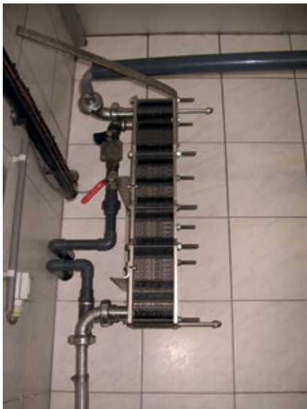
Warmtewisselaar en opslagvat voor warm water bij melkkoeling (Bron Innovatiesteunpunt)
