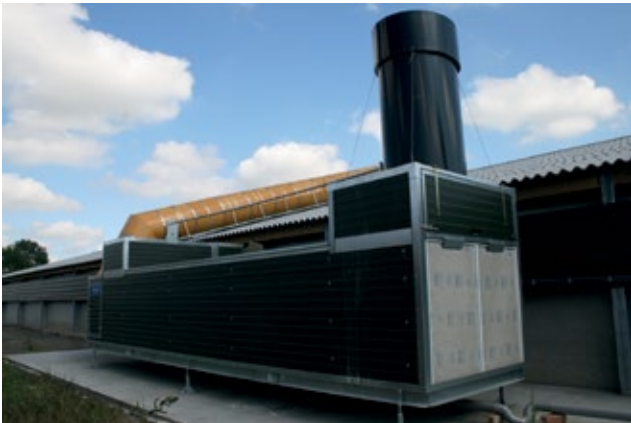
Warmtewisselaar in- en uitgaande stallucht (Bron Innovatiesteunpunt)
