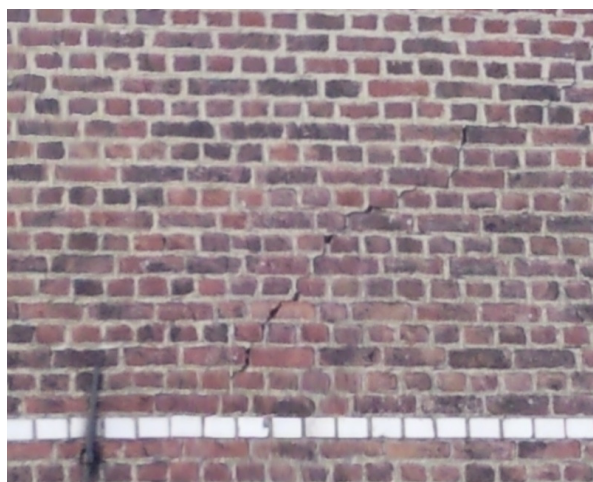
Figuur 17: Scheurvorming in metselwerk
