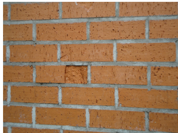
Figuur 21: Vorstschade aan bakstenen
