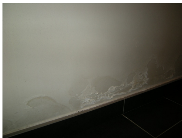
Figuur 16: Loskomen van de binnenbepleistering (boven) en zoutuitbloeiingen op de binnenbepleistering (onder)
