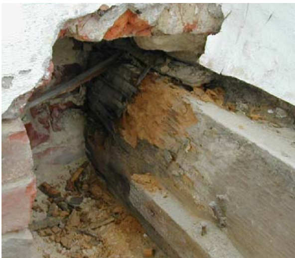
Figuur 19: Schade aan de houten balken ten gevolge van een hoog vochtgehalte op de plaats van de aansluiting met de gevel [Feist 2009]
