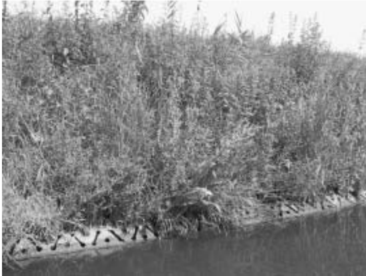
Foto 22. Bij betonnen doorgroeitegels werd een zekere begroeiing vastgesteld door enkele oeverplanten zoals Grote kattenstaart, Kluwen- en Waterzuring en vooral door ruigtekruiden zoals Grote brandnetel, Haagwinde en Ridderzuring. Toch blijven de vestigingskansen voor een rijke oevervegetatie laag, vooral ter hoogte van de waterlijn.
