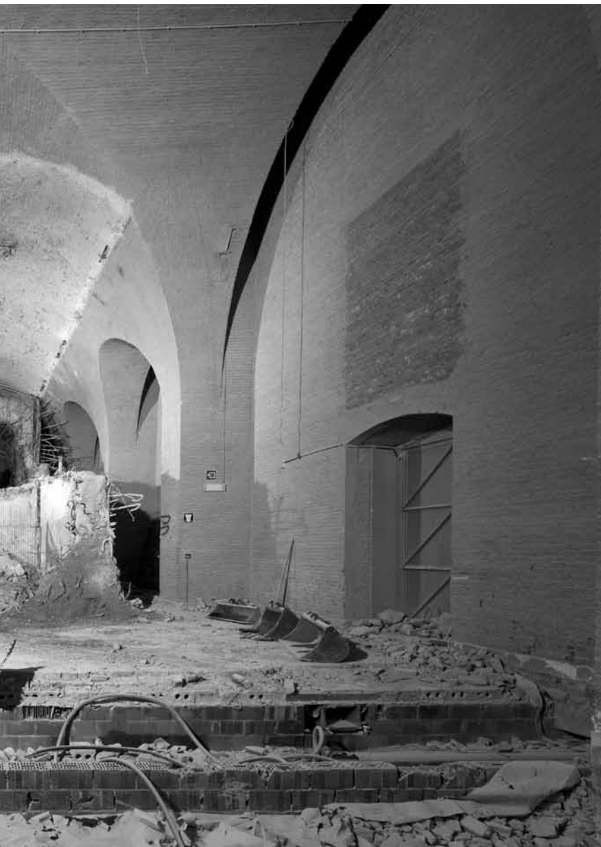
De afbraak van de atoomschuikelder in het hart van het museum vormde de eerste stap in de verbouwing door Claus en Kaan Architecten (situatie 2013).
