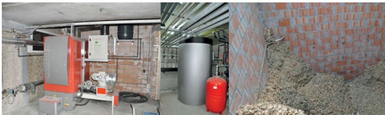
Afbeelding 13. Van links naar rechts: biomassa-installatie 80 kW, buffervat met een volume van 2000 l, voorraadbunker van ±30 m 3
