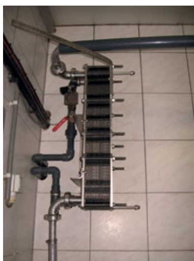
Afbeelding 4. Warmtewisselaar en opslagvat voor warm water bij melkkoeling
