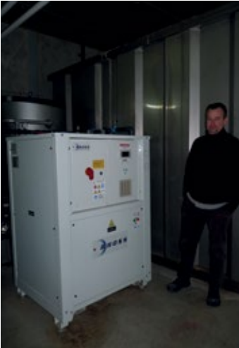
Afbeelding 16. Warmtepomp met buffervat
