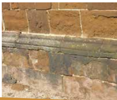
Korstvorming en verwerking ter hoogte van Diestiaan ijzerzandsteen in de plint. Sint-Eustachiuskerk in Zichem. Eigen foto
