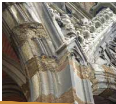
Vorstschade aan zwakke ijzerzandstenen tussen hardere steen. Sint-Sulpitiuskerk in Diest. Foto D. Van Gemert
