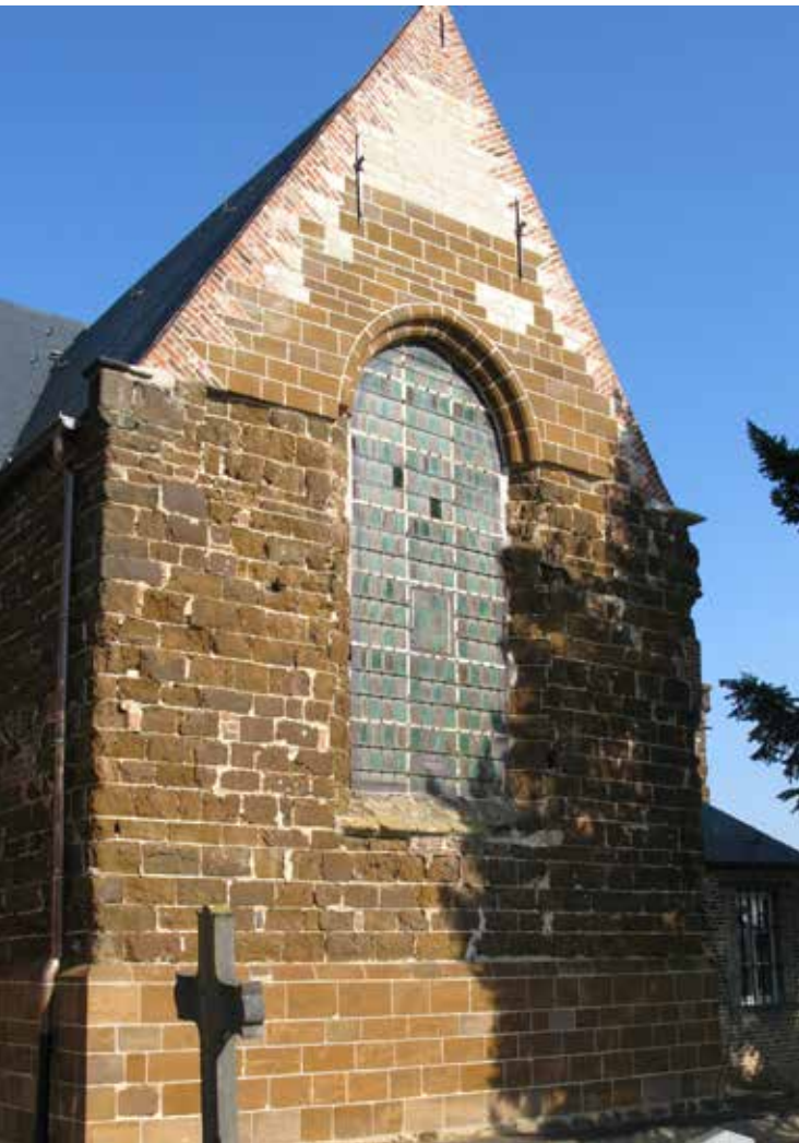
Kortrijk-Dutsel, Sint-Catharinakerk. Westtransept na fase 1 van de restauratie vervanging van de zeer sterk verweerde ijzerzandsteen. Foto Hilde Thibaut
