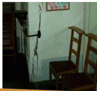
Scheurvorming onderaan de Sint-Willibrorduskerk in Meldert door kruipeffecten onder hoge belastingen. Foto Triconsult
