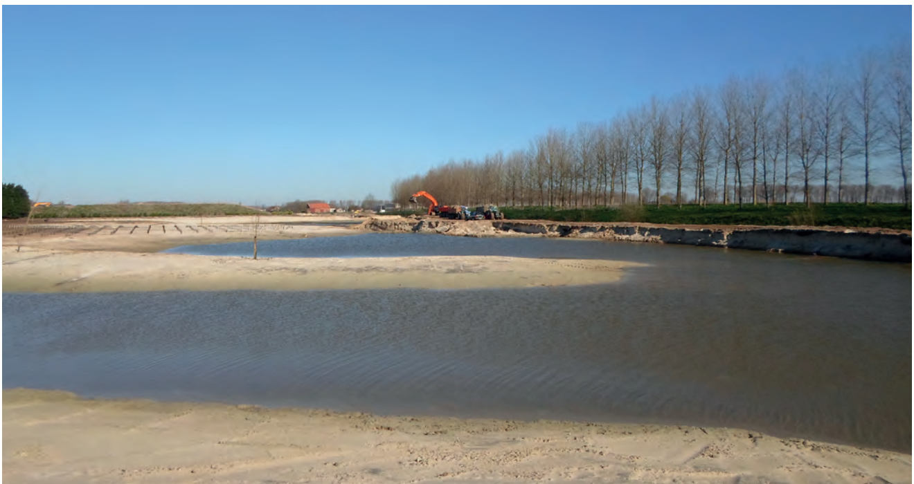
De werken lopen van de stuw aan de Gemenestraat tot aan de Schoorhavenweg. Foto van tijdens de werken.
