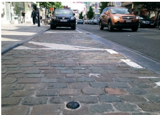
In de Shop & go-zone zijn de parkeerplaatsen uitgerust met sensoren © Stad Kortrijk.
