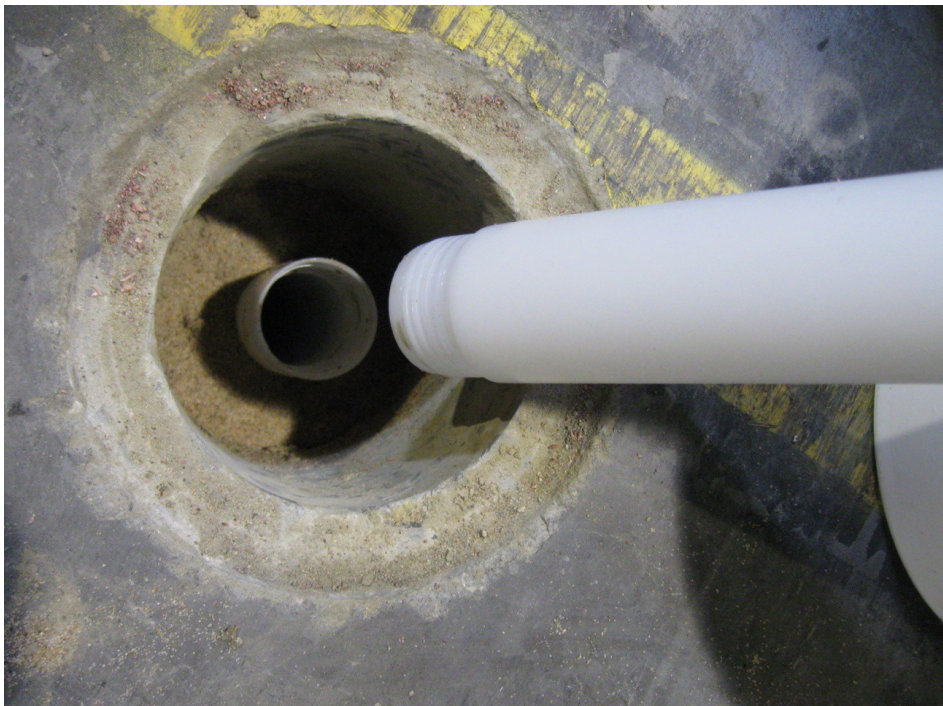
Figuur 43: Tijdelijke bovengrondse afwerking van een peilbuis met schroefdraaduiteinde
