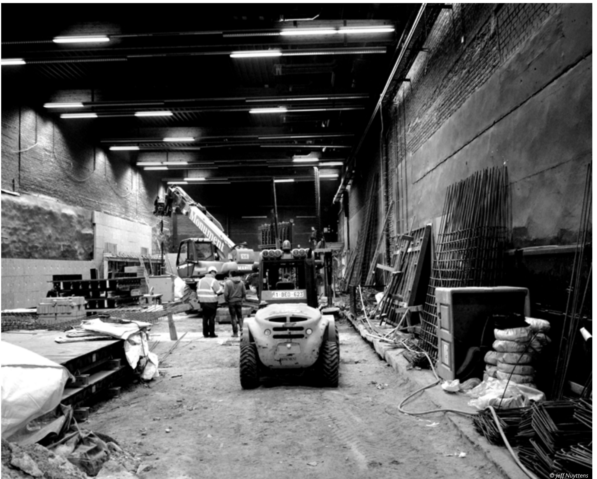
De renovatiewerken in de grote zaal van De Kriekelaar zijn volop aan de gang.
