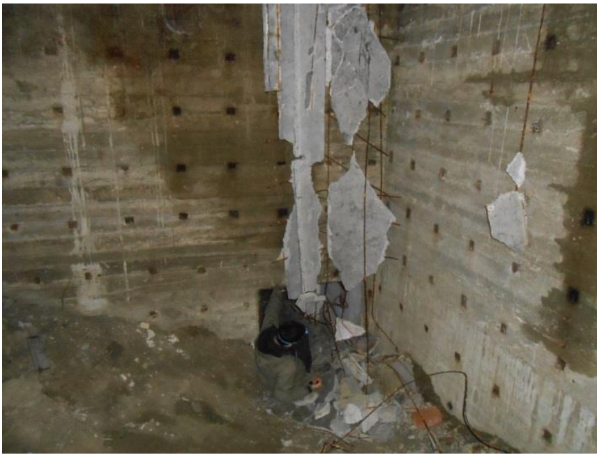
Figuur 12.3. Gevaarlijke doorgang in de COC-bunker (DP_04).
