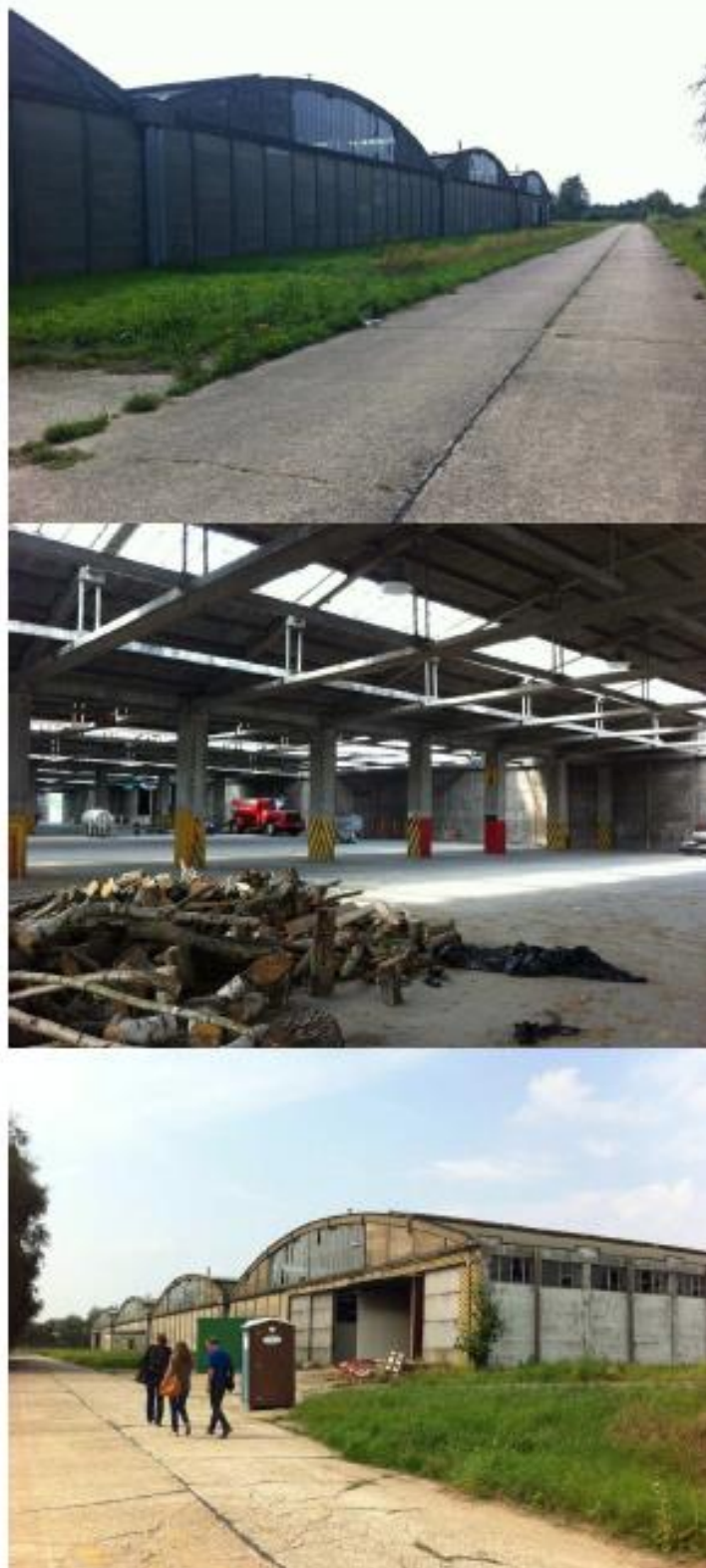
Figuur Campus Vesta 3-5: De her te bestemmen loods. © Provincie Antwerpen, Bestek: Campus Vesta – Bouwen van een erfgoeddepot, 47.
