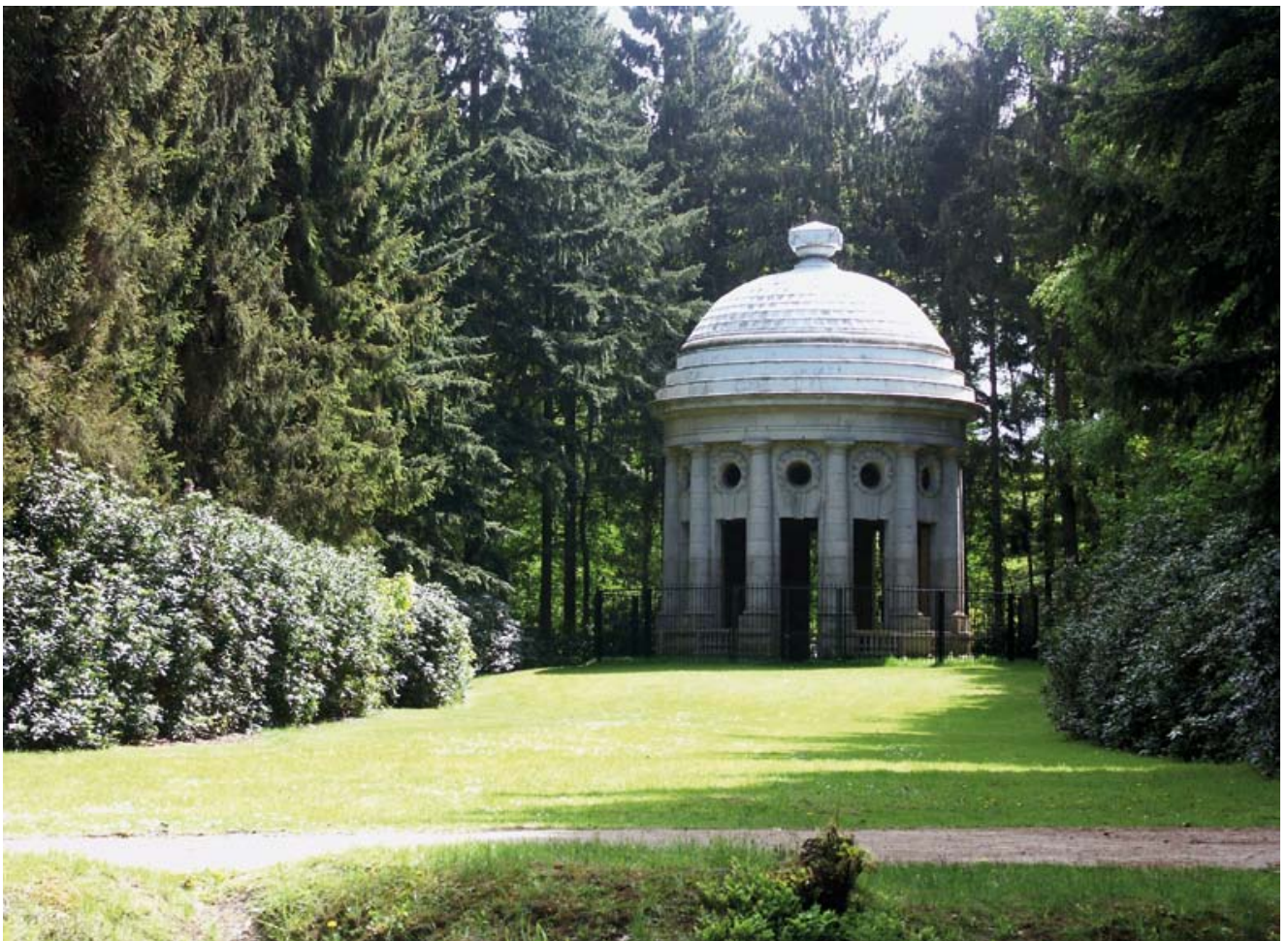
FIG. 125 In het park van Brasschaat staat een ronde tempel, die in de volksmond ‘de Peperbus’ wordt genoemd. Om vandalisme te voorkomen, werd rondom de tempel een stalen hek aangebracht. Er wordt nu naar een alternatieve oplossing gezocht die visueel minder storend is. Ook de zichttas zal opgewaarderd worden (foto: Dirk Artois).
