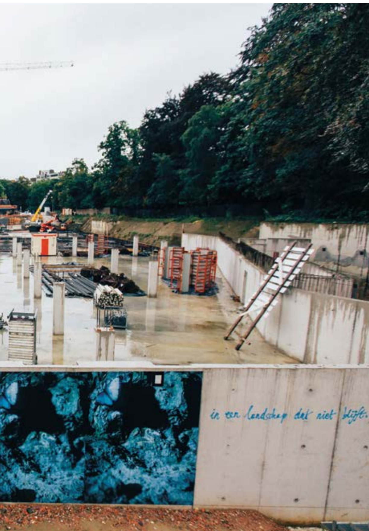
Nico Dockx Zonder titel (Als reizigers zonder bagage. Onderweg teruggeplooid tot het eigen lichaam. Onszelf te blijven in een landschap dat niet blijft.) 2015 spuitverf op beton variabele afmetingen
