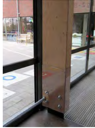
Plexi plaat en stalen stang ter bescherming van kolommen en glazen wanden. Sint-Gerardus Diepenbeek, © Inter
