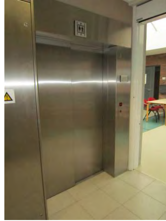
Lift met brede toegang. Omdat ze niet zo goed zichtbaar (herkenbaar) is, werd een extra pictogram bovenaan toegevoegd. Zorgcentrum Maria Ter Engelen vzw, © Inter
