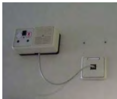
Een auditief alarm in de kamers van jongeren met een verstandelijke beperking. Op deze manier kan er 's nachts bij een oproep contact gelegd worden. Niet iedere gast heeft dit nodig. De aansluiting voor het systeem is wel in elk kamer aanwezig.
