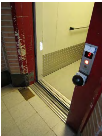
Beschadiging van de lift door een te smalle toegang. Aangepaste oproepknop aan de buitenzijde van de lift.
