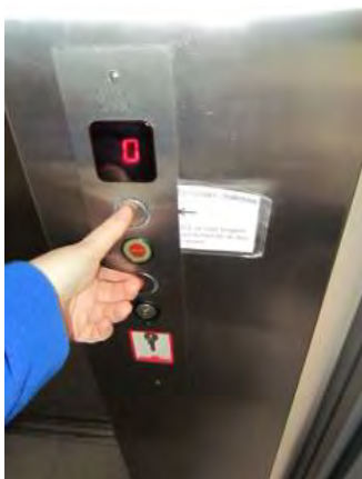
Toegang tot de lift is beveiligd doordat je twee knoppen tegelijk moet indrukken.
