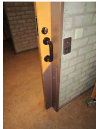
Bescherming van de deur: metalen hoekbeschermer voor het loshangende deel.
