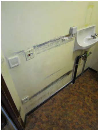
Beschadiging (op 2 hoogten) van de wand naastliggend aan de deur door elektrisch rolstoelgebruik (de ruimte is te klein om te manoeuvreren).
