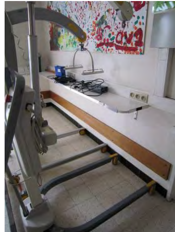
Laadpunt met meerdere stopcontacten per plaats.
