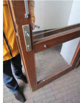
De klink aan de binnenzijde van de deur wordt verwijderd als beveiliging (noodoplossing).
