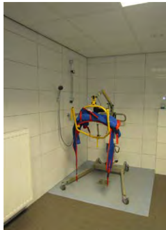
Vlakke douche met verrijdbare tillift. Naast de doucheglijstang is een extra douchekophouder op bereikbare hoogte voor zorgverleners.
