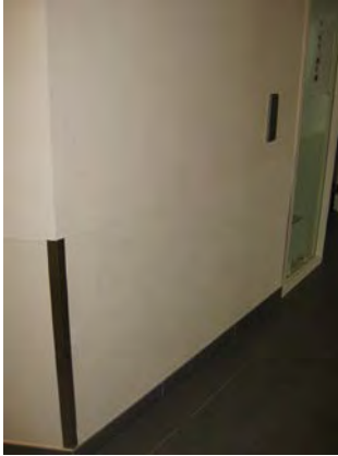
Bescherming van de hoeken d.m.v. inox hoekprofiel en van de wanden d.m.v. cementering en een afwerking met tusk (wandafwerking op basis van geslepen glasdeeltjes). Sint-Gerardus Diepenbeek, © Inter
