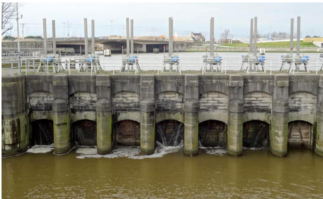
Figuur 25 Stroomafwaartse zijde van de spuiconstructie van het Afvoerkanaal Veurne-Ambacht ter hoogte van de Ganzepoot tijdens hoogwater. De lekkage van de spuischuiven is duidelijk waarneembaar. (foto © Nico De Maerteleire INBO)
