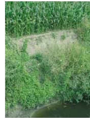
Mais tot op de oevertop leidt onder meer tot instabiliteit van de oevers door het gebruik van zware landbouwmachines en het ontbreken van een natuurlijke vegetatie die voor de gewenste stabiliteit kan zorgen.
