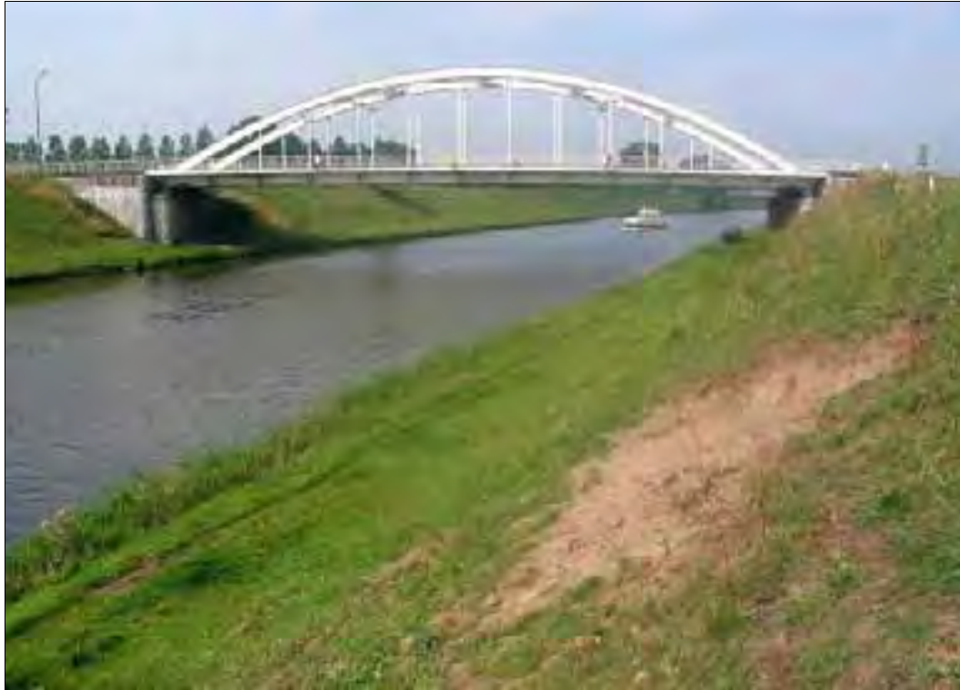
Foto 20. Overbegrazing leidt niet alleen tot een ecologisch minder waardevolle vegetatie, maar kan op steile taluds ook tot erosieproblemen leiden, door de geringere doorworteling van de zode. De foto toont de rechteroever ter hoogte van Hansbekebrug.
