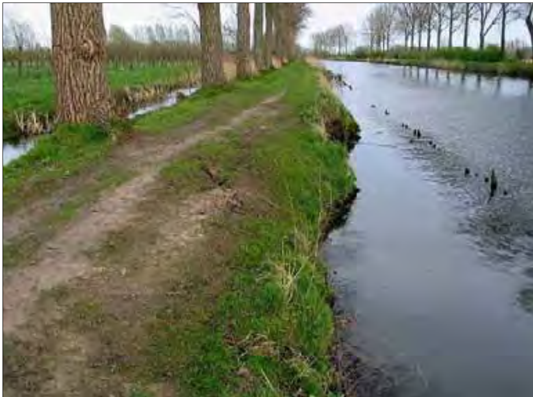
Foto 13. Ondermeer tussen Knesselarebrug en Sint-Jorisbrug (bovenste foto) en t.h.v. Leiemeersen-Noord (onderste foto) komen oeverafkalvingen voor die enkele meters van het jaappad wegspoelen. Dit is problematisch wanneer de vegetatie op het jaappad een belangrijke natuurwaarde heeft of behoud van vrije doorgang cruciaal is voor het beheer van de kanaalbermen. Te Leiemeersen-Noord wordt een waardevolle vegetatie (met Kattedoorn, Gewone agrimonie en Goudhaver) bedreigd.
