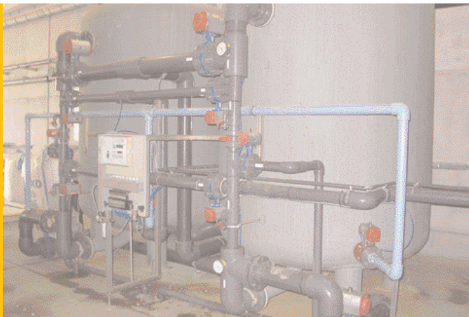
Als alternatief voor diep grondwater wordt uit ondiep grondwater proceswater bereid; foto: onthardingsinstallatie.
