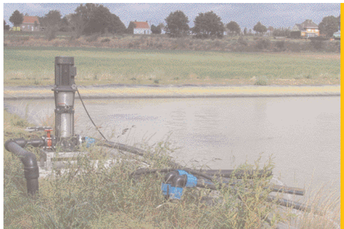
Regenwater van daken wordt gebufferd in een opvangbekken met bodemzeil en gebruikt voor koeling en stoomproductie.
