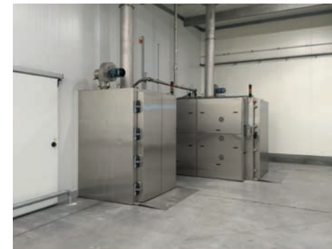
Dirk Van Guyze @DRGUYZ 8 sep 2016 Nieuwe vriesinstallatie op de Vlaamse Visveling Zeebrugge. In 15 min invriezen zonder verlies aan kwaliteit. pic.twitter.com/qGQ7pg5K9
