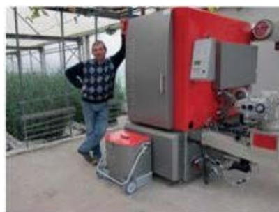
Houtstookinstallatie op een landbouwbedrijf (Bron: Goed geboerd? Ook het klimaat is u dankbaar. )
