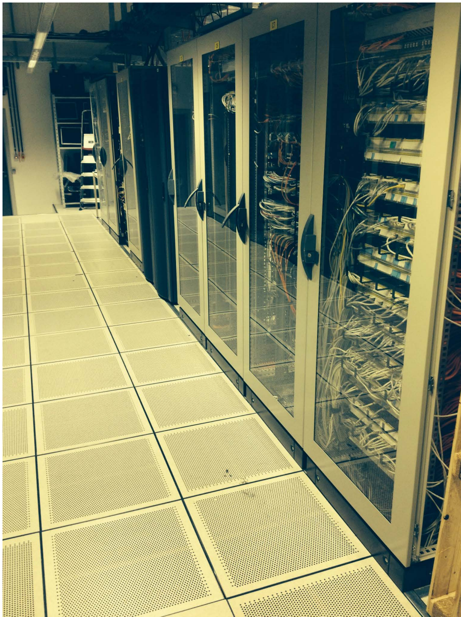
Foto: het serverlokaal van het Agentschap voor Landbouw en Visserij in het Ellipsgebouw (Brussel). De servers van de SALV zijn in dit systeem opgenomen en worden, met het oog op efficiëntie, samen met de servers van het agentschap beheerd.
