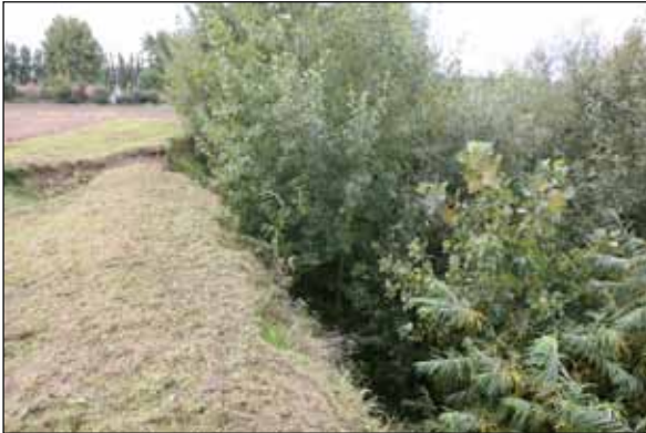
Fig. 12: Zicht op een steilrand van een grondverschuiving.
