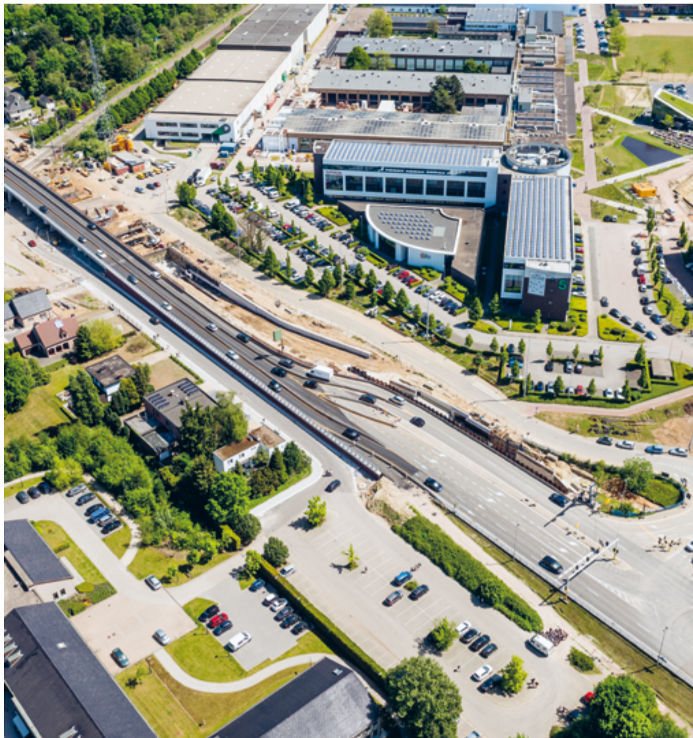
De tidal flow op het viaduct van de Kempische steenweg in Hasselt in werking.
