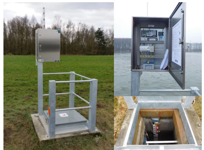
Figuur 2. Nieuwe situatie - druksonde en peilschaal in meetput, veilig afgeschermd met luik - datakast met GPRS-antenne
