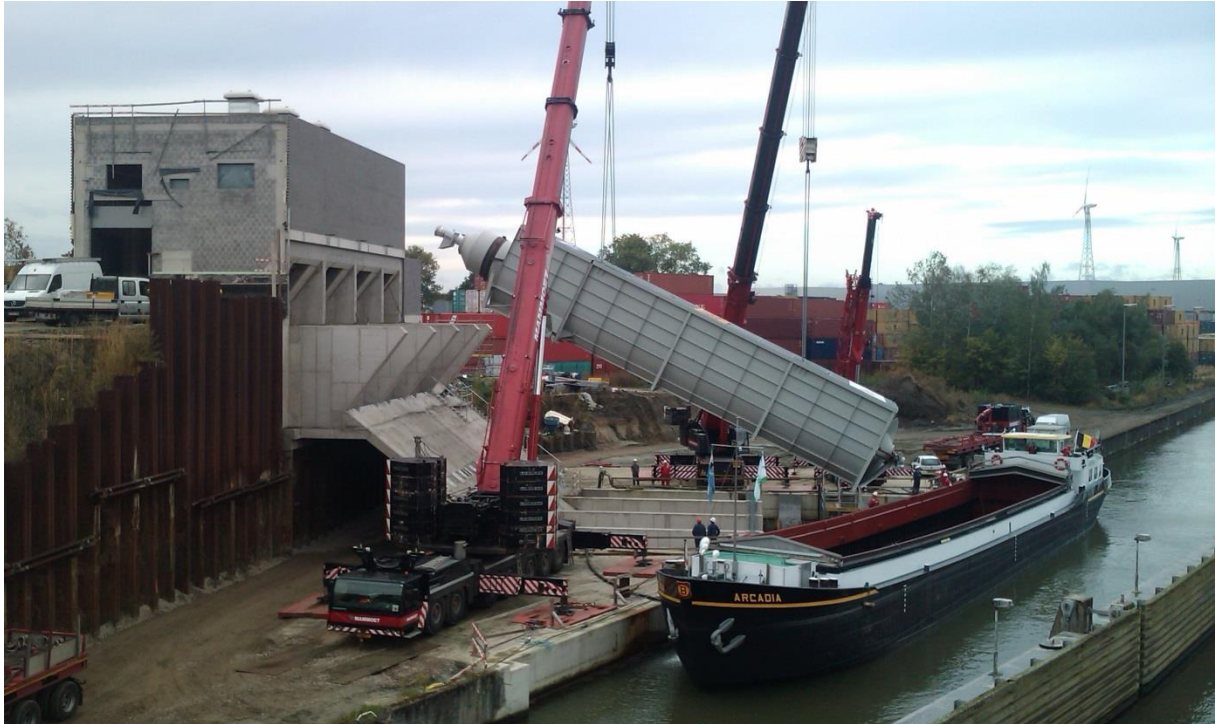
Figuur: Albertkanaal: pompinstallatie op het sluisencomplex van Ham
