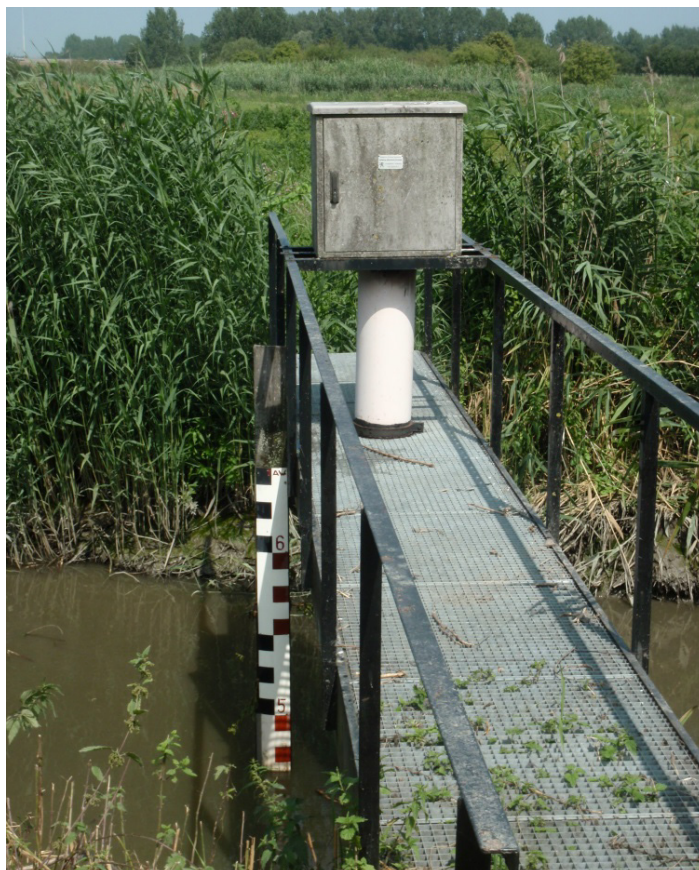
Figuur 34 - Tijmeetinstallatie te Zele op de Durme.
