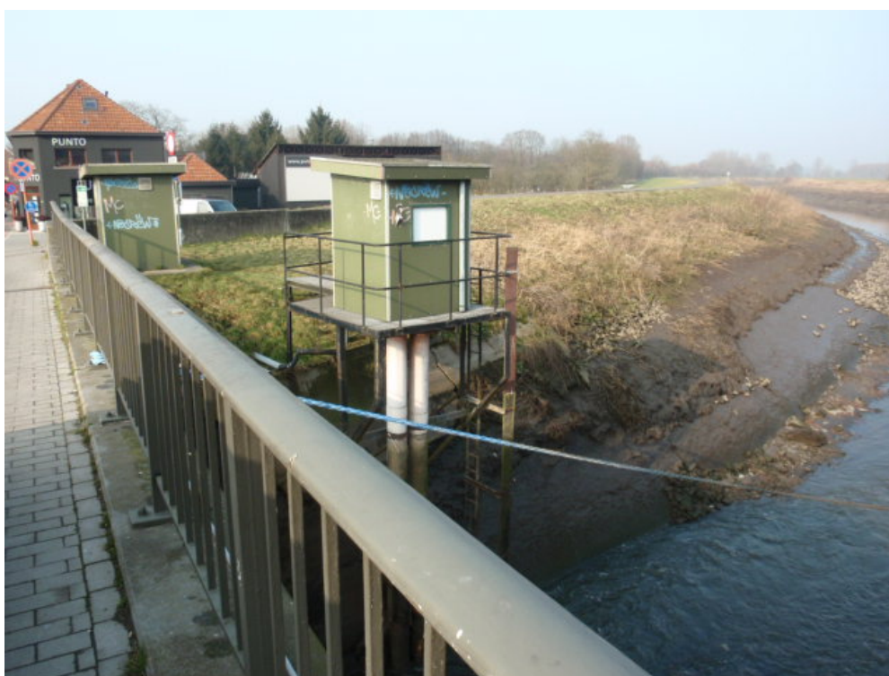
Figuur 30 - Tijmeetinstallatie te Hombeek op de Zenne
