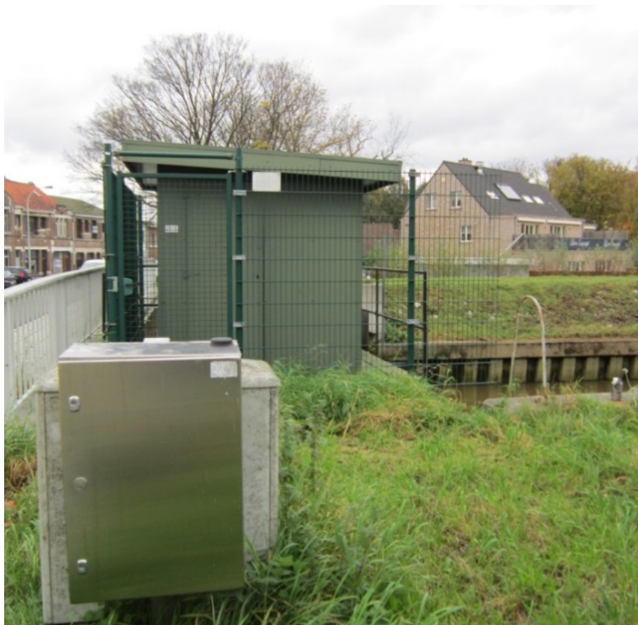
Figuur 27 - Tijmeetinstallatie te Lier Maasfort op de Grote Nete
