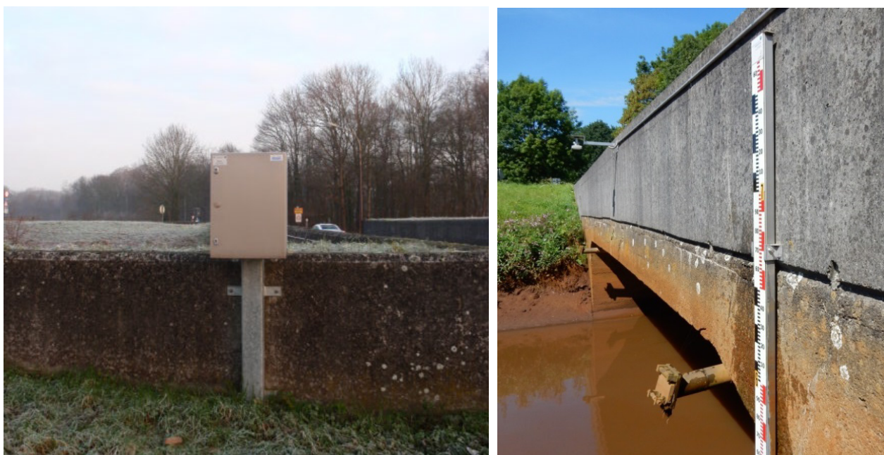
Figuur 28 - Tijmeetinstallatie te Kessel op de Grote Nete
