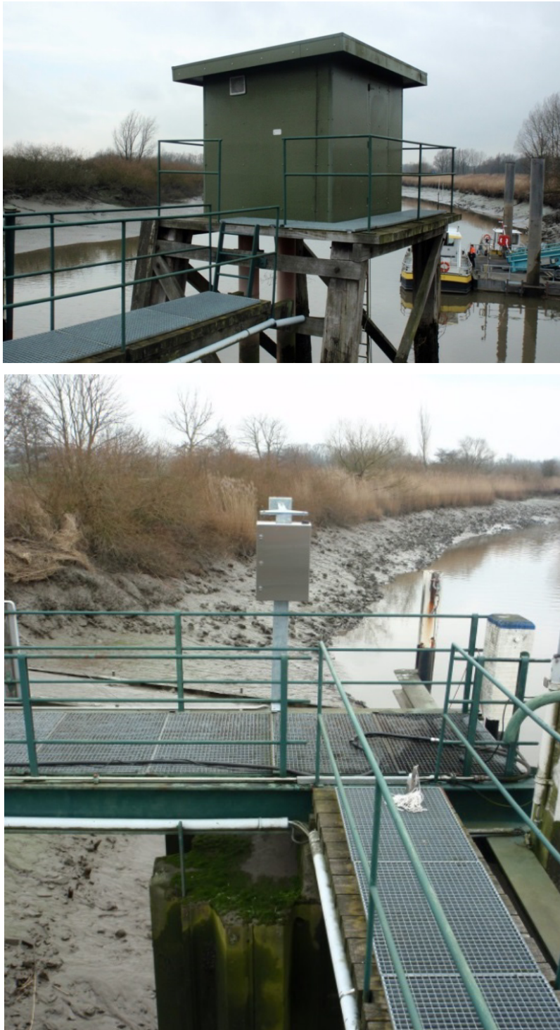
Figuur 32 - Tijmeetinstallatie te Tielrode op de Durme
