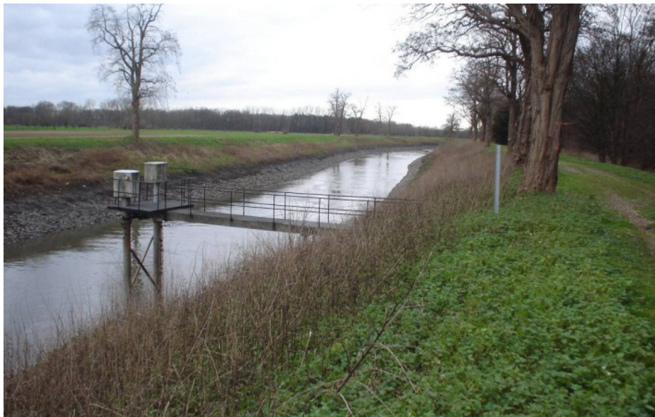
Figuur 31 - Tijmeetinstallatie te Zemst op de Zenne
