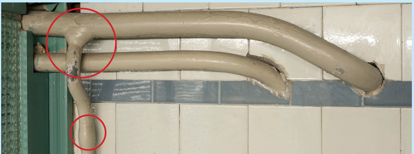
figuur 5: Loden leidingen in oudere gebouwen: vaak gebogen en met verdikkingen
