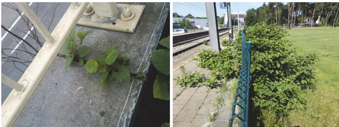
Figuur 30 (links) Invasieve duizendknoop groeit doorheen de kieren van de boordstenen.
