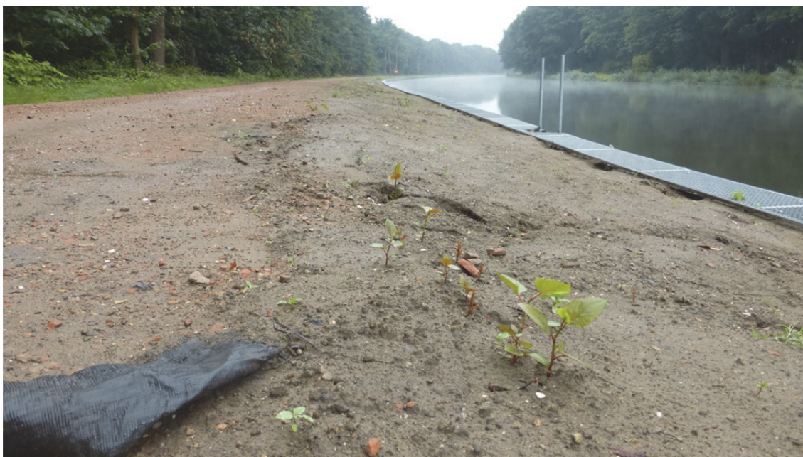
Figuur 17 Bij de aanleg van deze kanaaloever (kanaal Bocholt-Herentals) werd geen rekening gehouden met de aanwezigheid van invasieve duizendknoop. Besmette grond werd hergebruikt in de toplaag.
