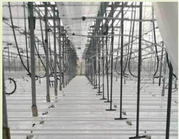
Foto: Zicht op de serre na e aanmaning, De folie werd zoals gevraagd volledig vervangen
