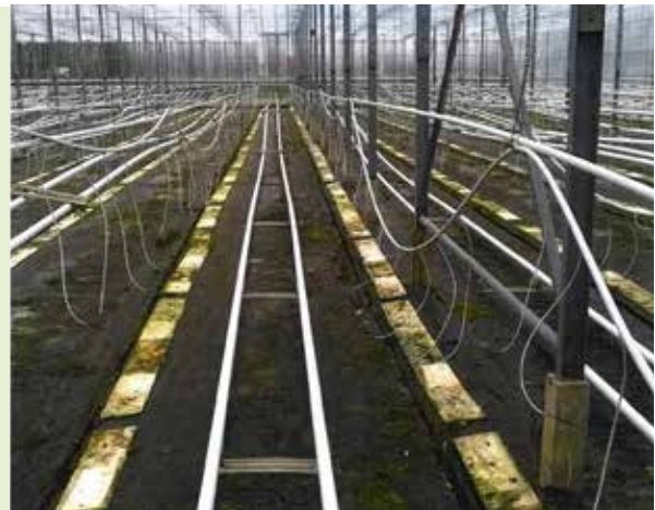
Foto: Zicht op de serre zonder planten, de plastic folie is versleten. De VMM maande de tuinbouwer aan om de folie te vervangen en de aansluitingen op de afvoerbuizen ook te vernieuwen.
