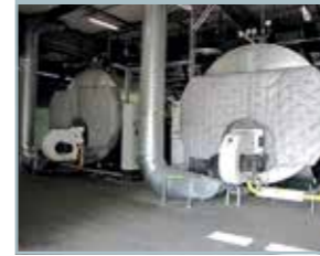
demonteerbare isolatie rond keteldeuren [1]
