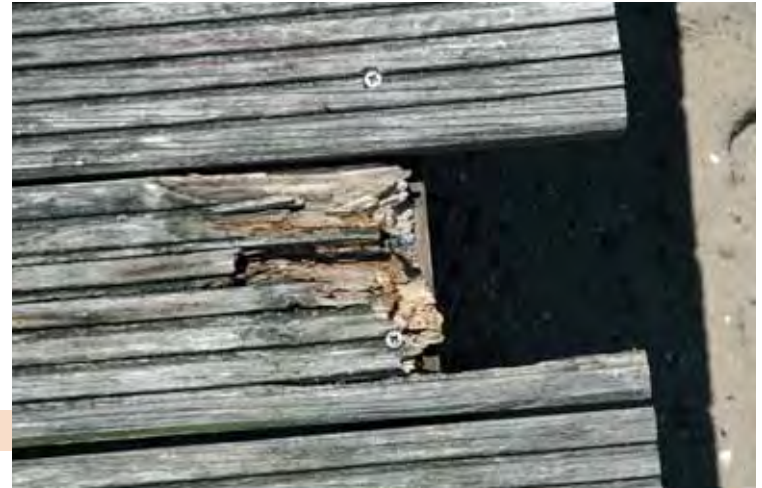
Slecht onderhoud van het vlonderpad
