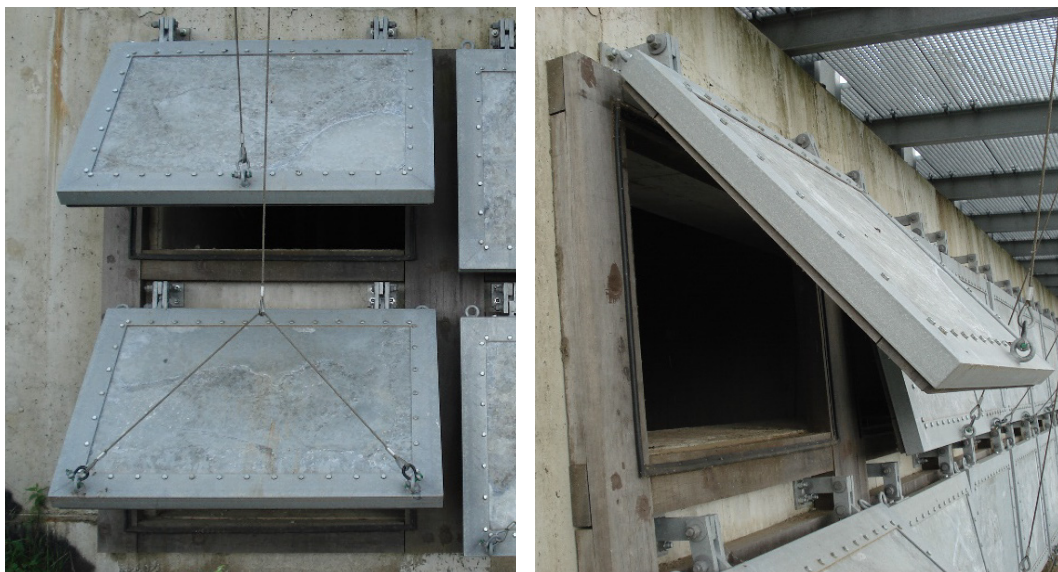
Uitwateringsconstructie GOG-GGG Kruibeke
