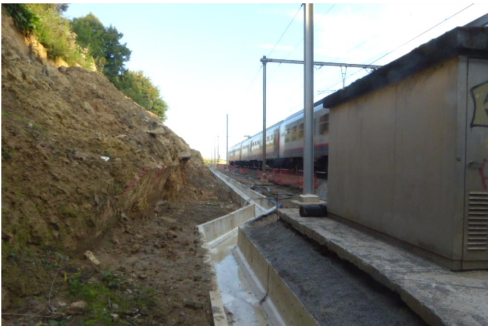
Figuur 38: De restanten van de tunnelmuur aan de brug (© agentschap Onroerend Erfgoed).
