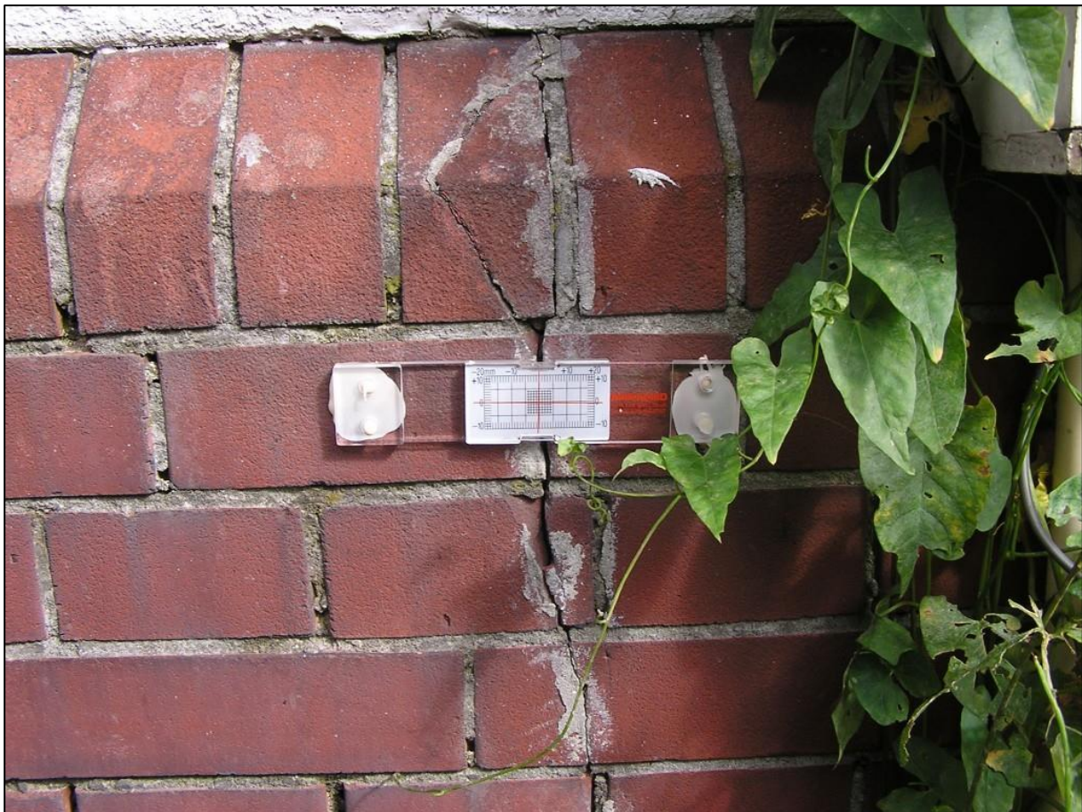
Figuur 60 voorbeeld van een scheurmeting door middel van een 'Tell-tale'
