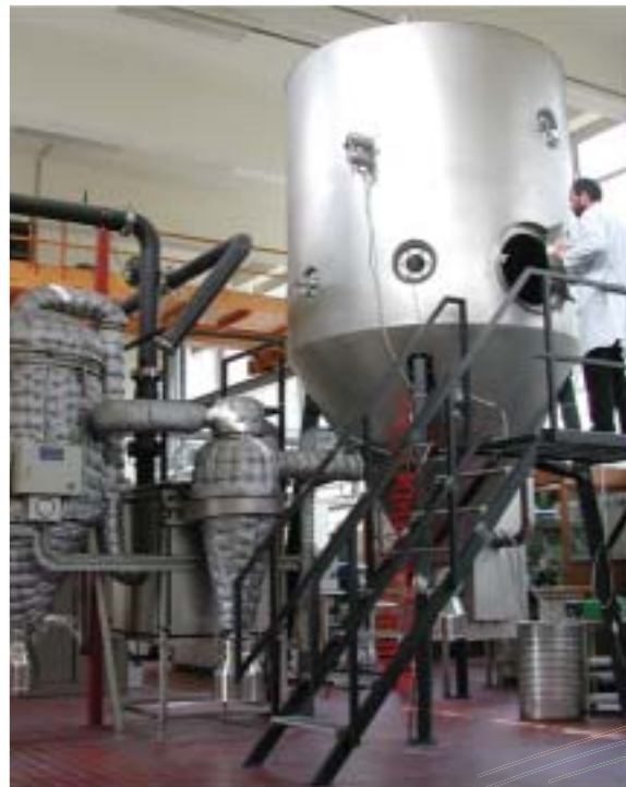
Sproeidrooginstallatie in VITO
