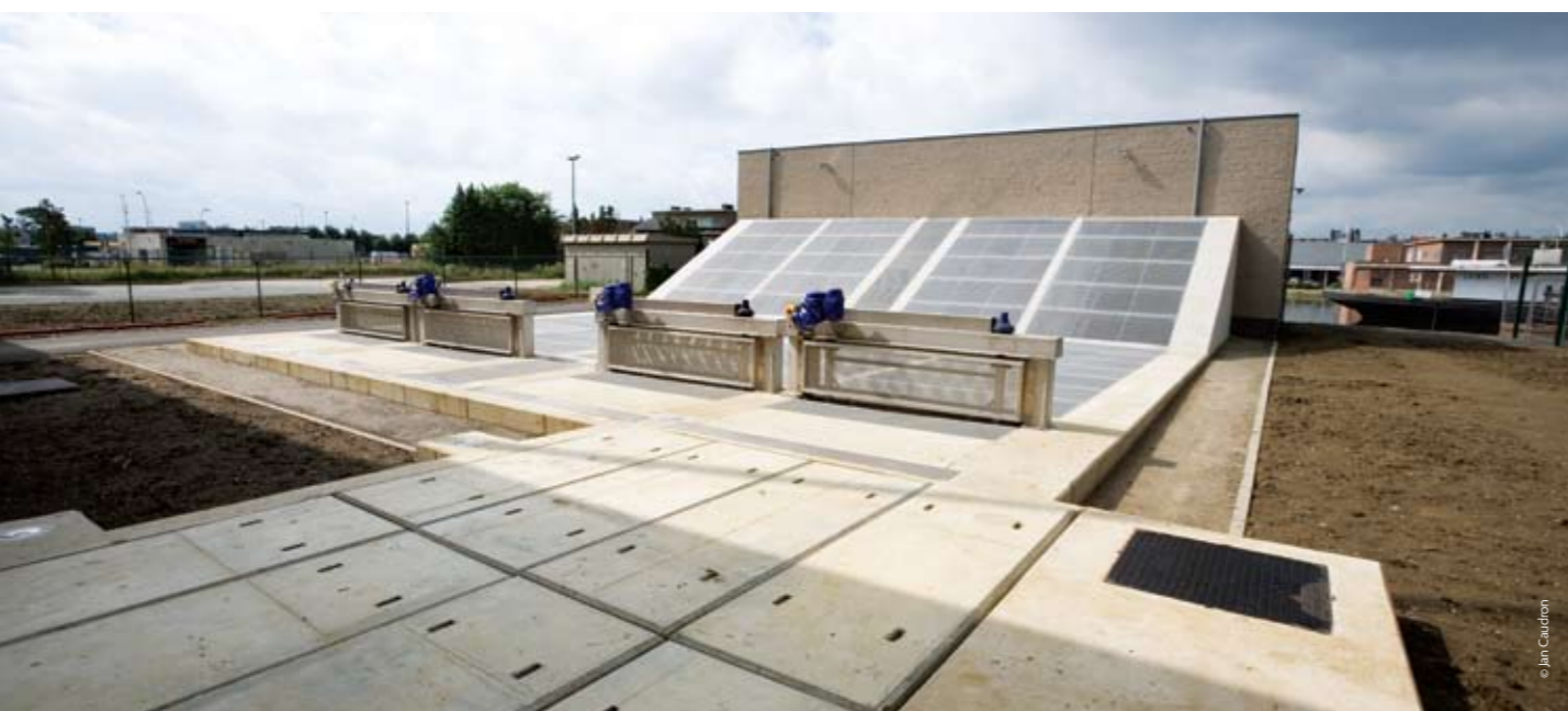
Nieuw pompstation aan het Lobroekdok ter hoogte van het Antwerpse Sportpaleis.
