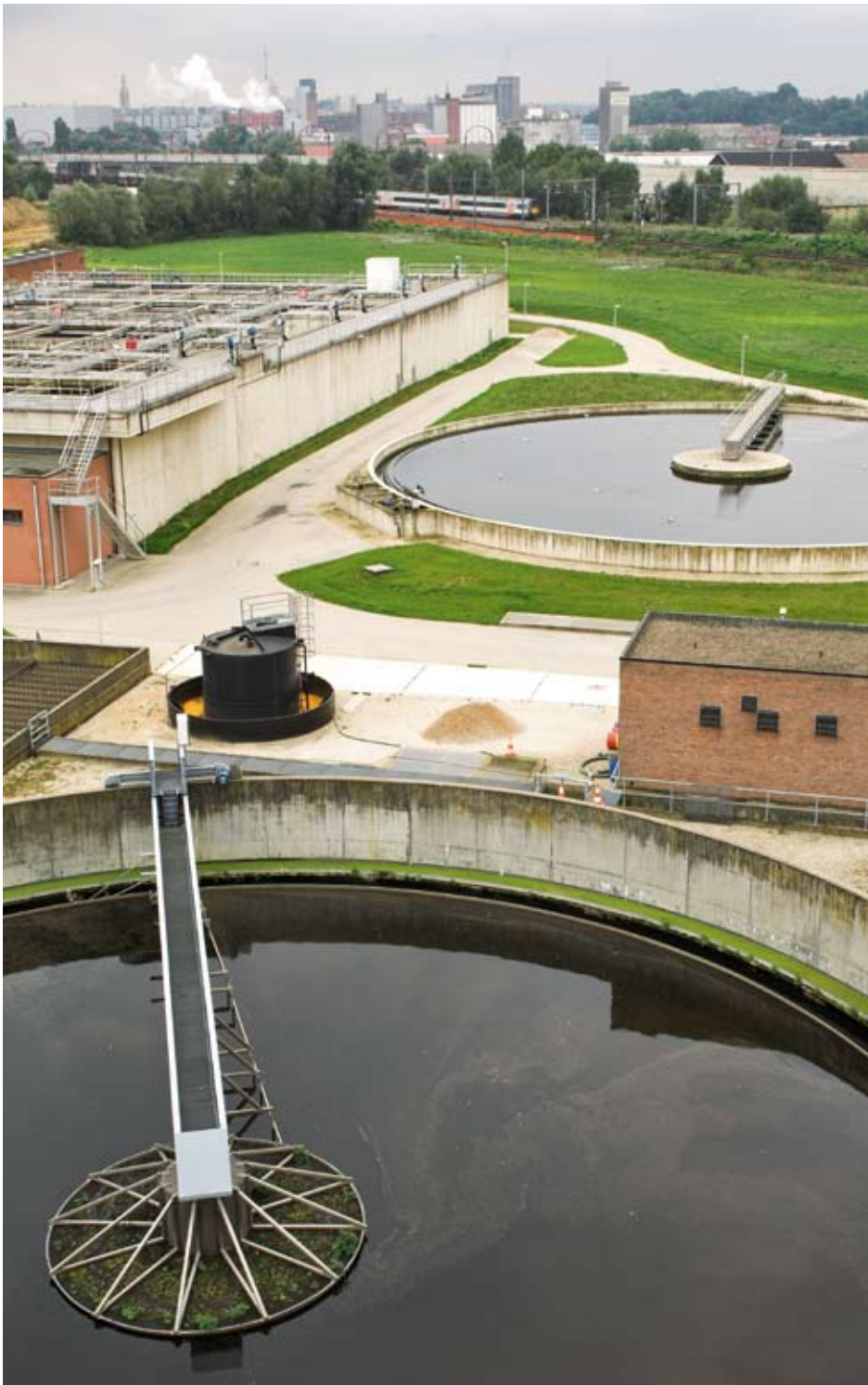
Een van de 238 waterzuiveringsinstallaties van Aquafin
