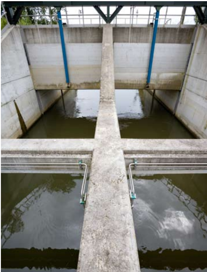
Stuw van het wachtbekken op de Dijle in Leuven
