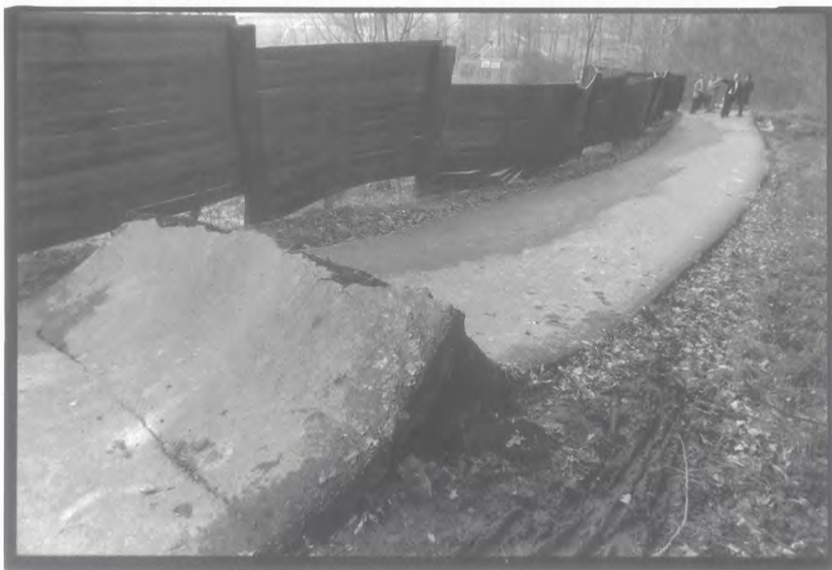
De asfaltweg is zeker een meter omhooggeplooid.
