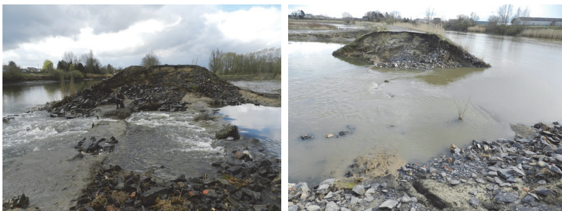
Figuur 13-2. Foto's onvolledige dijkdoorbraak te Wijmeers februari 2016 (situatie tot eind mei 2016).
