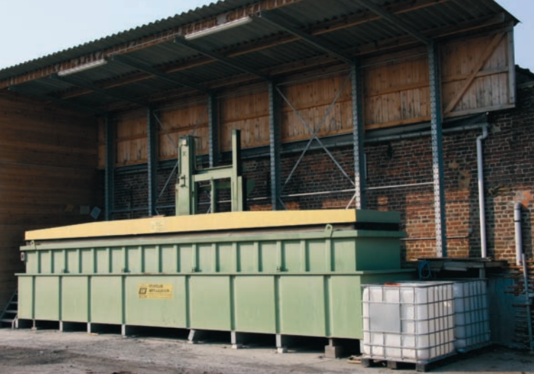
Houtbehandelingsinstallatie bij een van de gecontroleerde bedrijven
