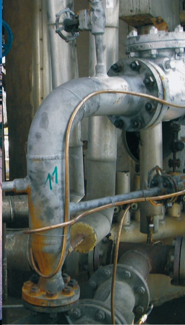
Onvoldoende beveiliging tegen brand van de afsluiters en slechte ergonomie voor de bediening van de afsluiters waren mede oorzaak van de brand
