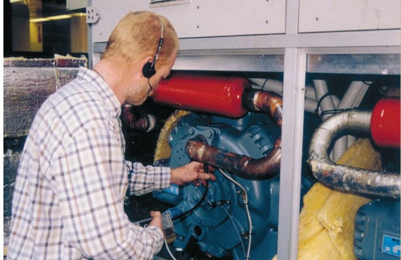
In 67 van de 78 gecontroleerde bedrijven werden koelinstallaties aangetroffen die niet lekdicht zijn
