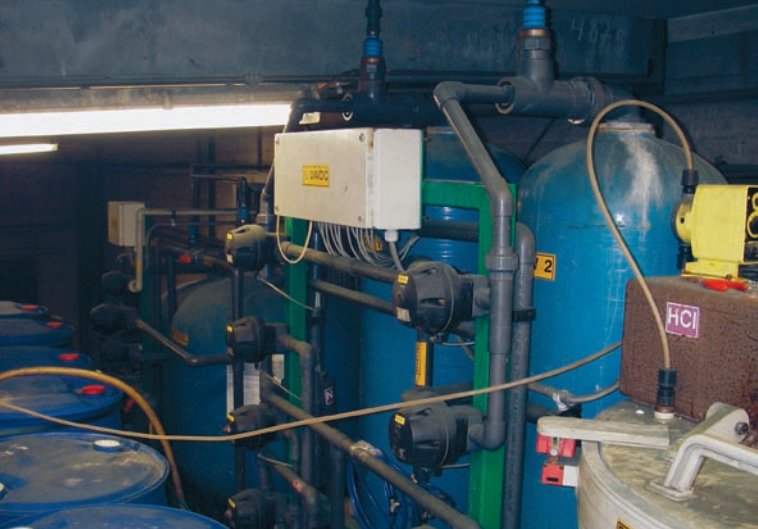
De MI-aanmaningen leidden tot een sanering van de lozing van bedrijfsafvalwater, o.a. door een aanpassing van de waterzuiveringsinstallatie
