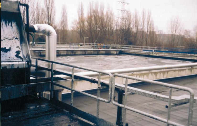
Ook bij de waterzuivering van het bedrijf ontstond er geurhinder
