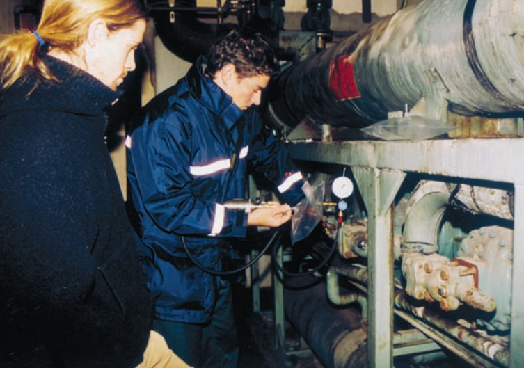
In 10 van de 20 geanalyseerde monsters werden sporen van verboden koelmiddel gevonden
