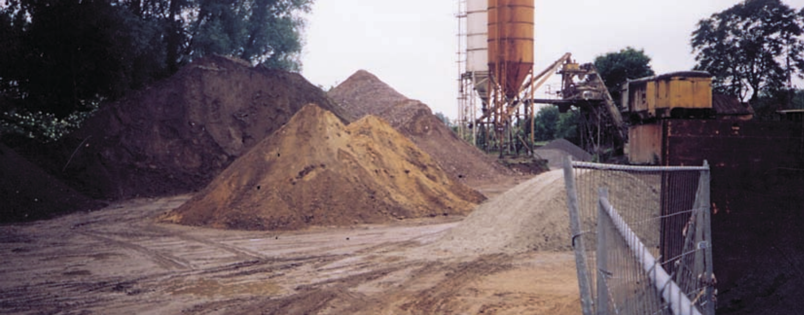
De betoncentrale met puinbreekinstallatie exploiteerde verder zonder milieuvergunning: MI vroeg een heroverweging na een sepot van de procureur des Konings
