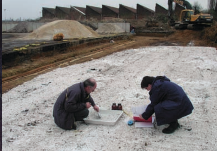
MI stelde vast dat er in een funderingsput illegaal afvalstrooizout was gedumpt
