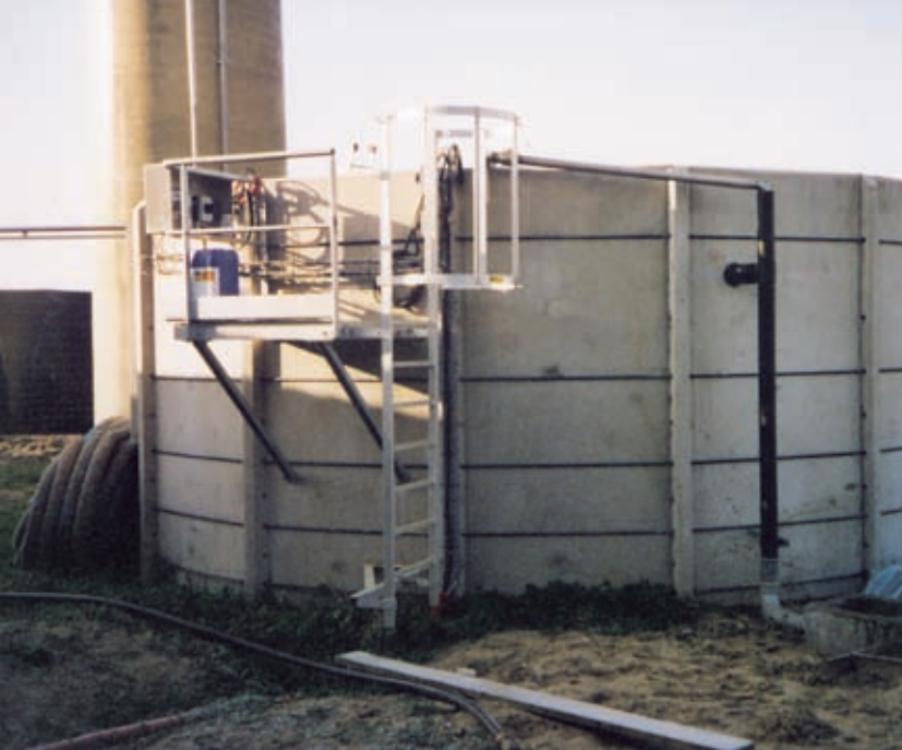
Het aardappelschilbedrijf bouwde een nieuwe biologische waterzuivering en voldeed daarmee aan de lozingsnormen
