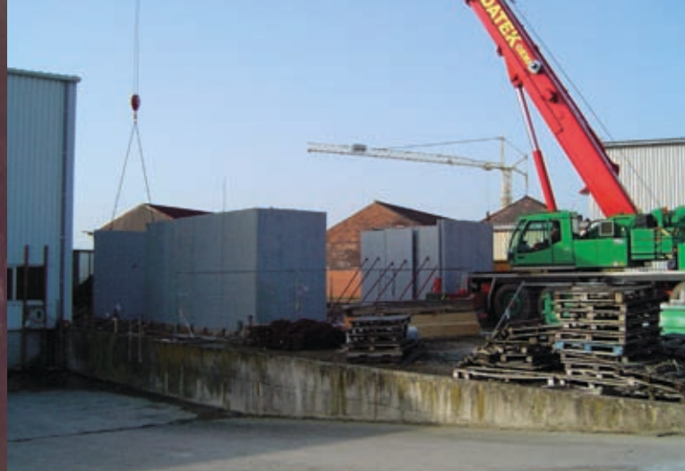
De exploitant zorgde voor een uitbreiding van de bestaande waterzuivering en kon daarmee voldoen aan de geldende lozingsnormen
