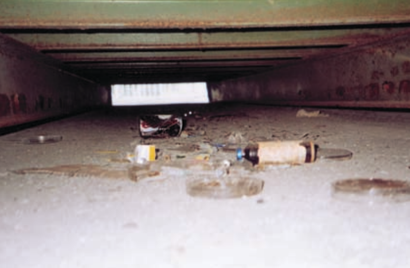
MI stelde een proces-verbaal op omdat afvalstoffen met een duidelijk medisch karakter rondslingerden rond de container voor de opslag van RMA
