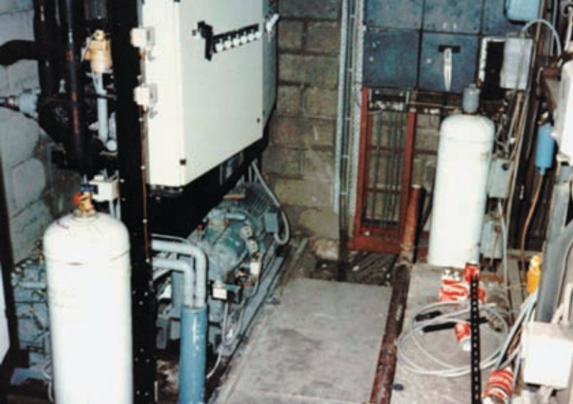
Voorbeeld van een slecht beheerde koelinstallatie
