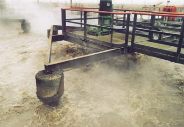
De biologische waterzuivering veroorzaakte heel wat geurhinder
