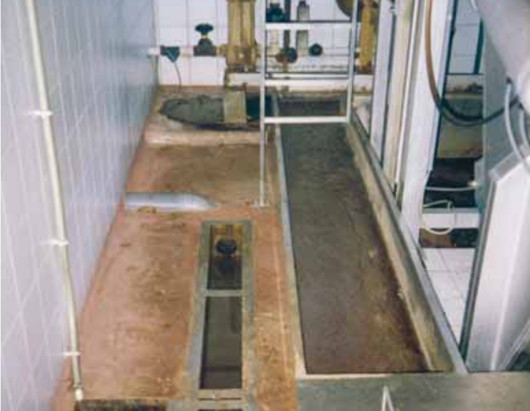
Lozingsconstructie (links op de foto): MI controleerde ook hier de lozing van gevaarlijke stoffen.
