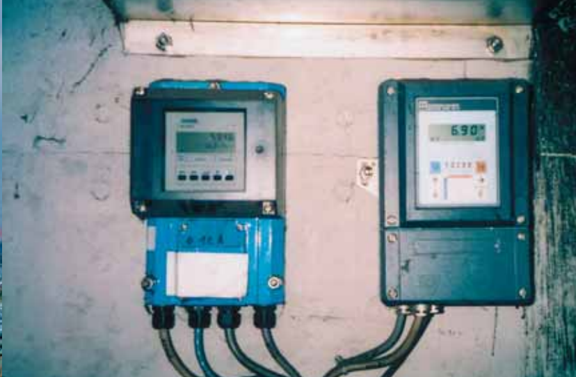
De gecontroleerde bedrijven moeten continu de pH, de temperatuur en het debiet van het afvalwater meten.
