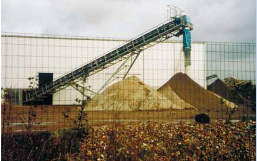
De overkapping van de breek- en zeefinstallatie moest stof- en geluidshinder oplossen.
