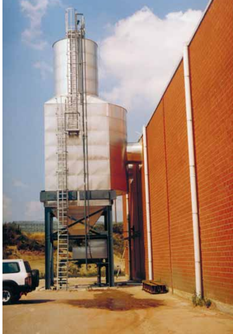
De rookgaszuivering bij een steenbakkerij moet zorgen voor het naleven van de emissienormen.
