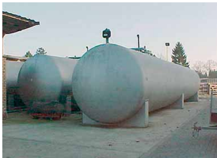
De illegale opslag van een vloeibare afvalstof in een bovengrondse tank.
