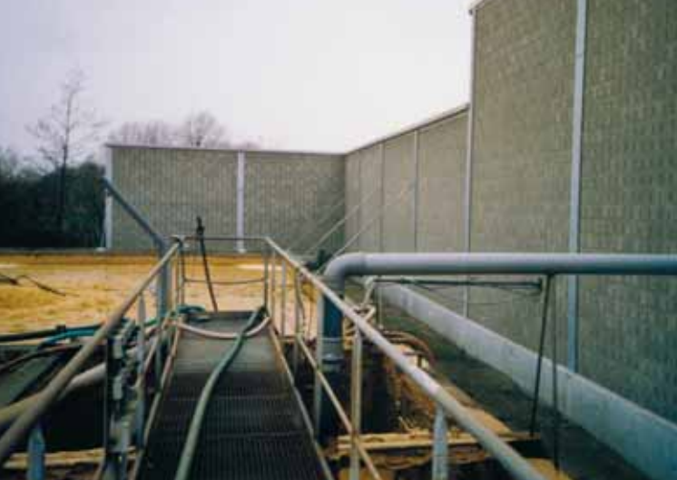
Het geluidswerend scherm langs de waterzuivering bestaat uit soundbetonblokken en moet de geluidshinder voor de buurtbewoners beperken.
