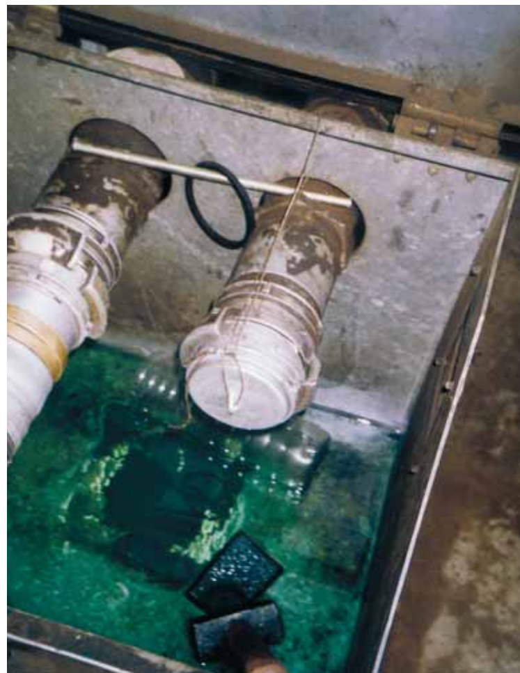
De burgemeester gaf het bevel tot sluiting en verzegeling van de vulmonden van de tanks.
