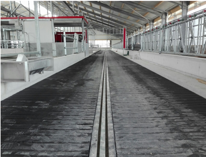
Figuur 14: V-vormige vloer met rubberen mat en centrale giergoot (bron: Opti-Cow)
