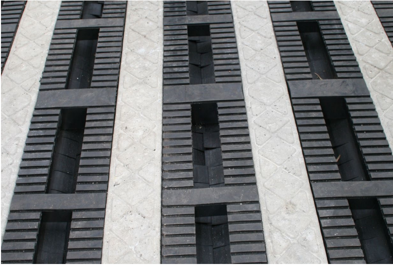
Figuur 13: Roostervloer met rubberen inlegcassettes en afsluitkleppen
