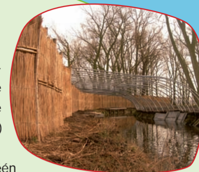
zicht op de herstelde vangpijp (V)
