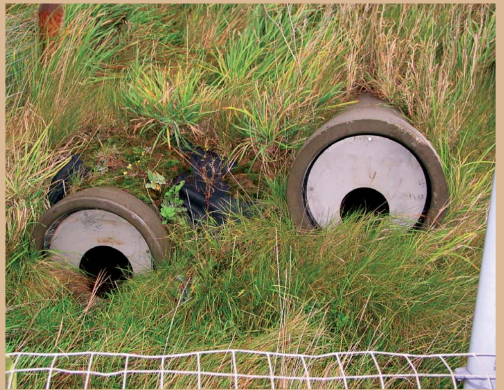
Foto 3: Een dubbele knijpconstructie op verschillende hoogte in het damlichaam zorgt er voor dat het uitstroomdebiet groter wordt naarmate het water achter de dam hoger staat. Zo vermindert de kans dat een dam overstroomt.
